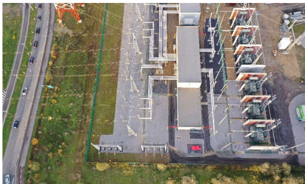
Voorbeeldfoto van een bestaand GIS-onderstation te Lillo 380kV
