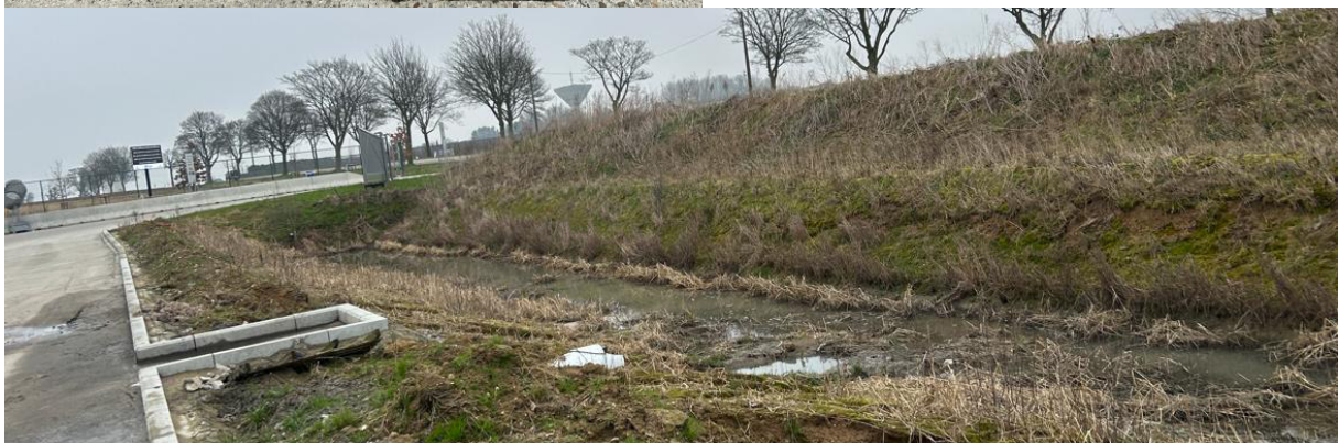
Figuur 21 Een opvanggoot (boven) die hemelwater vanaf het tasveld afvoert naar het lagergelegen bufferbekken (onder).
